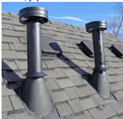
Ventilācijas izvads/ dūmenis ar šķērslī
